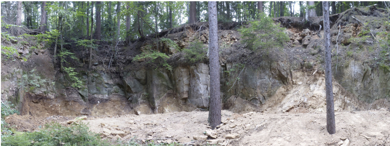
Abbildung 14. Die ca. 10 m hohe Nordwand des heutigen Sandsteinbruchs Nr. 104 im Sommer 2020 (Foto: F. Haubrich 2020). Der Werksandstein der oberen Oberhäslich-Formation im unteren Abschnitt ist über eine Länge von ca. 40 m komplett freigeräumt worden. Die hangenden spiculitischen Siltsteine der Pennrich-Formation sind gut sichtbar, aber nicht gefahrlos zu erreichen.
